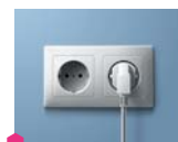
Entretien des interrupteurs, des prises (y compris celles du téléphone, de la TV et Internet)
