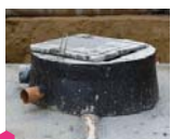
Si fosse septique, entretien du regard et du caniveau en individuel
