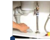
Entretien des tuyaux d'alimentation
